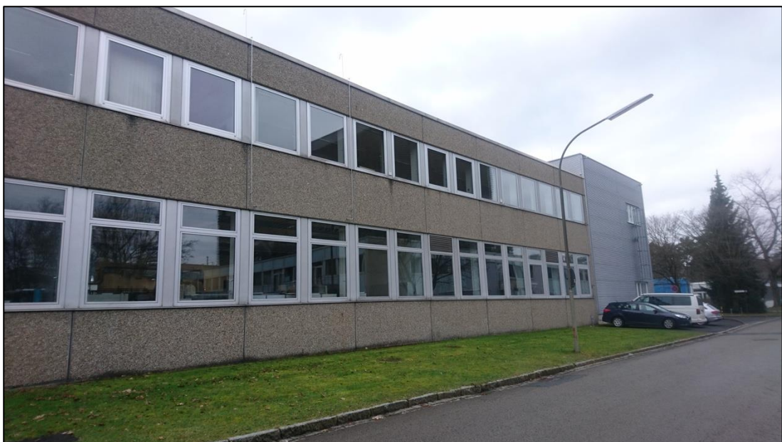
Abb. 10: Bau 56 Gebäudeaußenwand mit Waschbeton verkleidet, Spalten hinter Traufblech, gesamte Front
