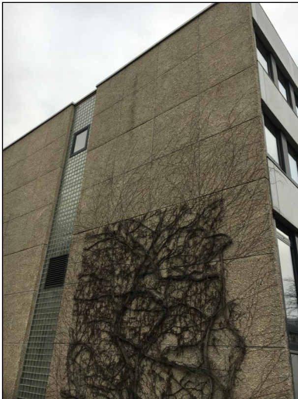
Abb. 9: Bau 51 Gebäudeaußenwand mit Waschbeton verkleidet, Spalten hinter Traufblech
