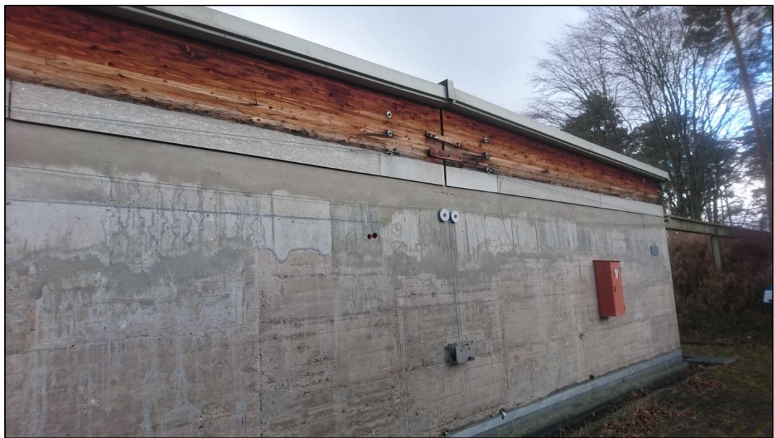
Abb. 11: Bau 67-4 Betonmauerwerk, Holzaufbau unter dem Trauf mit Spalten
